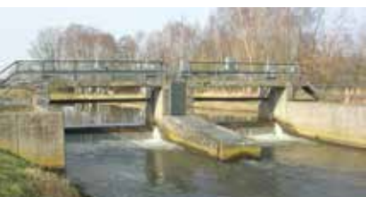
Wehr an der Nieplitz, Brandenburg, zur Regulierung des Grundwassers
