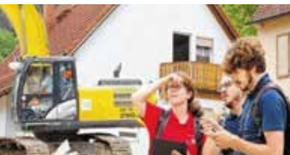
Schadensaufnahme nach der Sturzflut in Braunsbach, Baden-Württemberg
